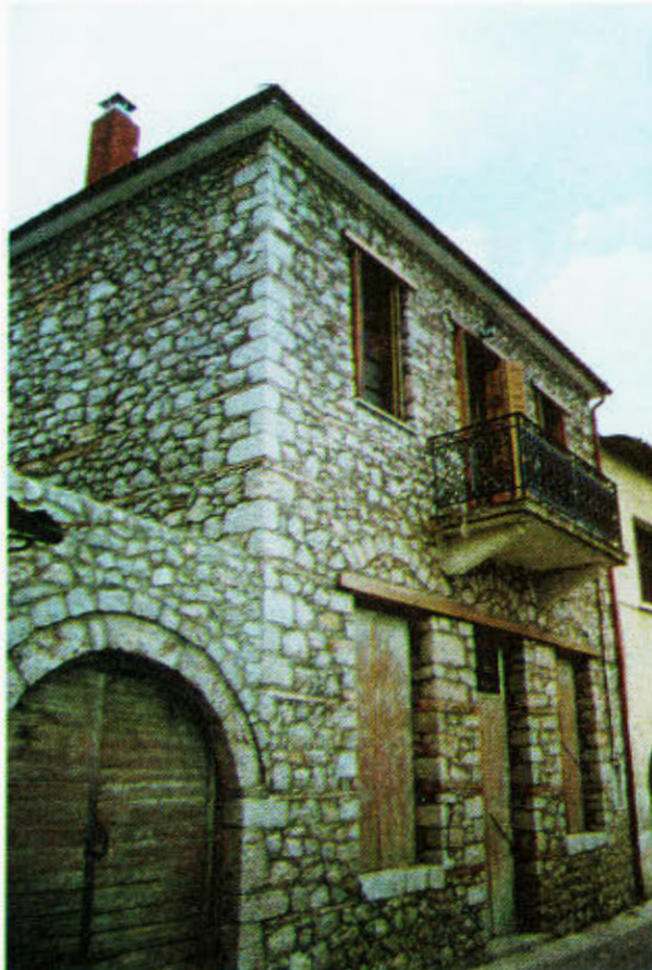
Φωτ. 9.9. Σπίτι στην Αράχωβα. Αργολιθοδομή με υπέρθυρα ξύλινα και λίθινη αψίδα, γωνιόλιθους και ξυλοδεσιές.
