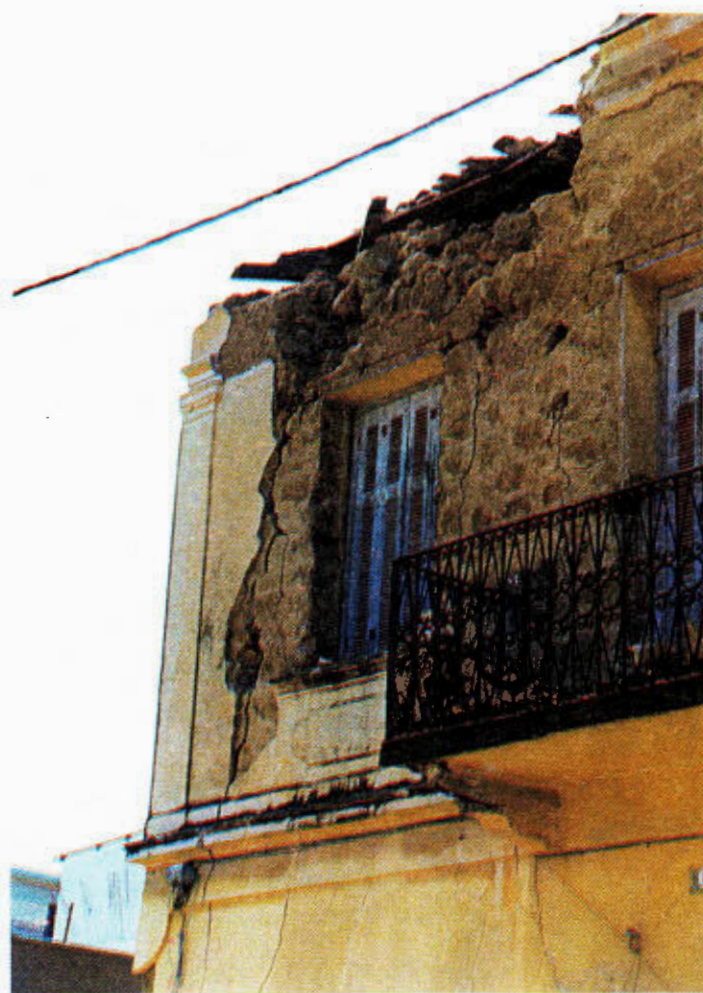
Φωτ. 8.5. Σεισμόπληκτο κτίριο.
