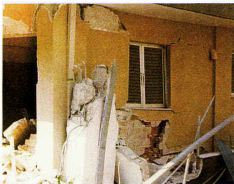
Φωτ. 11.1. Κατάσταση κτιρίου στην Καλομάτα μετά τον σεισμό του 1986.
