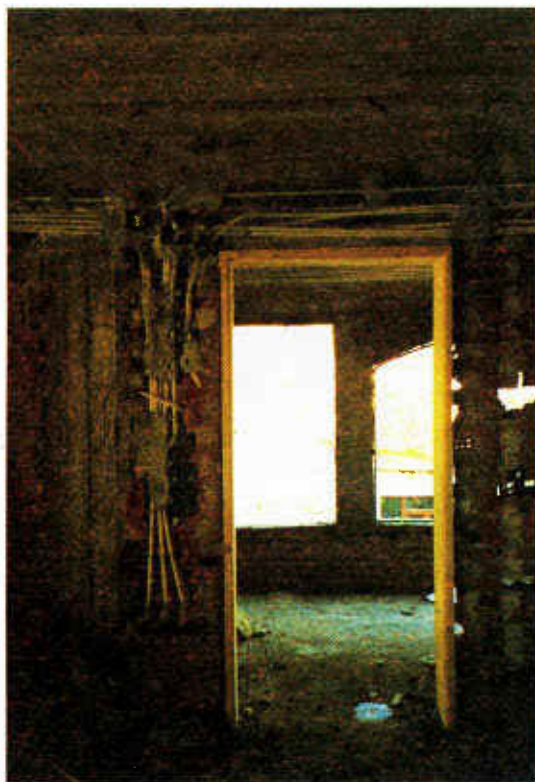
Φωτ. 11.3. Κακοτεχνίες σε οπτοπλινθοδομή.
