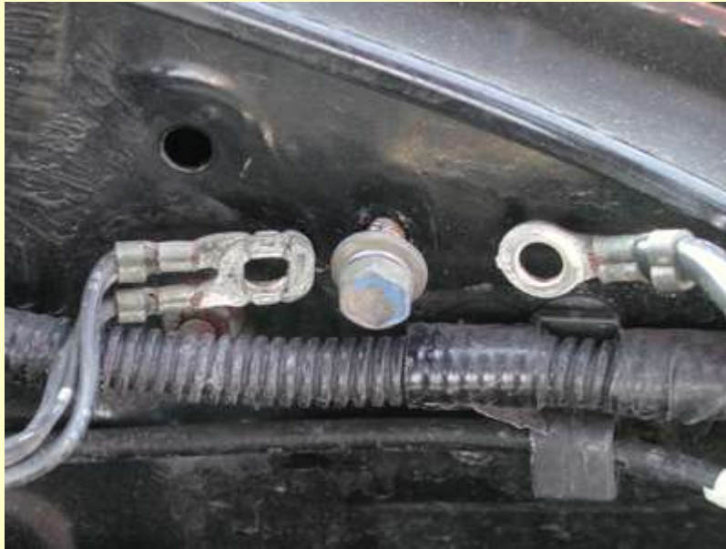
Εικόνα 3: Η κακή σύνδεση γείωσης
